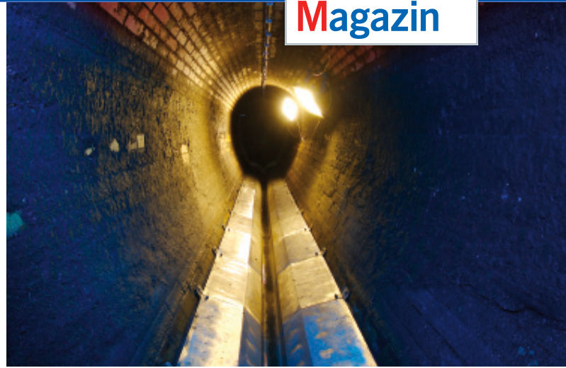
Bild 1: Zwei Drittel der 20 in Deutschland installierten Anlagen zur Abwasserwärmegewinnung setzen Wärmeübertrager auf der Kanalsohle ein.
